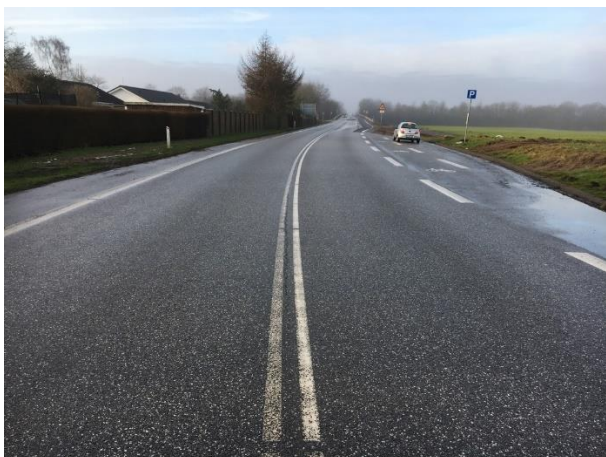
Foto 1. Skadespoint 0,24, Hellevadvej, 800 meter, vejklasse 1, hovedeftersyn 2016, foto fra 2017. Skader: Få rivninger / meget lidt mørteltab
