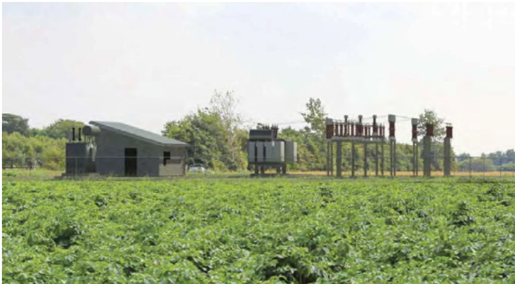
Figur 5.2: Eksempel på step-up transformer omkranset af trådhegn, inden separat beplantning er etableret.
