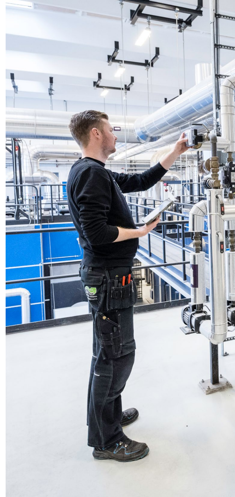
Aabenraa Fjernvarme og de øvrige fjernvarmeselskaber i kommunen forsyner ca. 10.600 husstande i Aabenraa Kommune med fjernvarme
