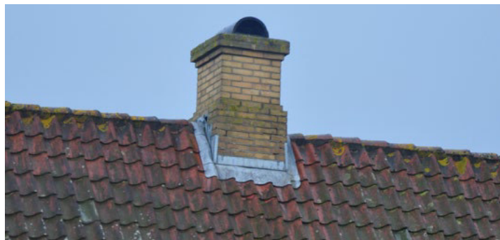
Vægterpladsen 1, traditionelt udført skorstenspipe med blyinddækning, der er 'trappet' ind i soklens murværk
