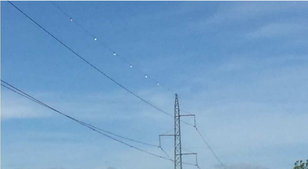
Figur 3 Markeringer på jordledningen (øverst) af luftledning ved Dybsø
