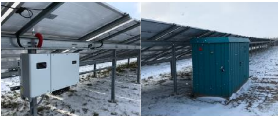
Eksempler på inverter (venstre) og distributionstransformer (højre). Valget af de endelige typer af teknisk udstyr sker først i projekteringsfasen.
