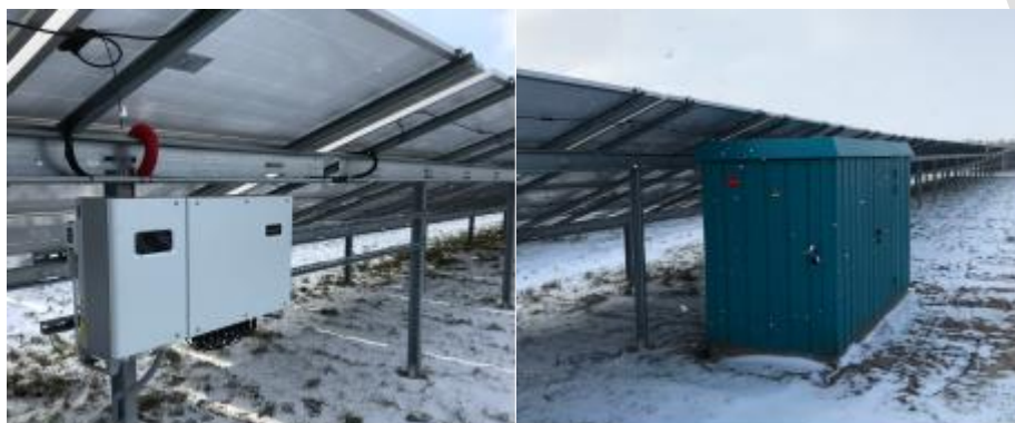
Eksempler på inverter (venstre) og distributionstransformer (højre). Valget af de endelige typer af teknisk udstyr sker først i projekteringsfasen.
