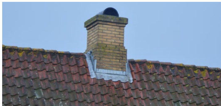
Vægtørpladsen 1, traditionelt udført skorstenspipe med blyinddækning, der er 'trappet' ind i soklens murværk
