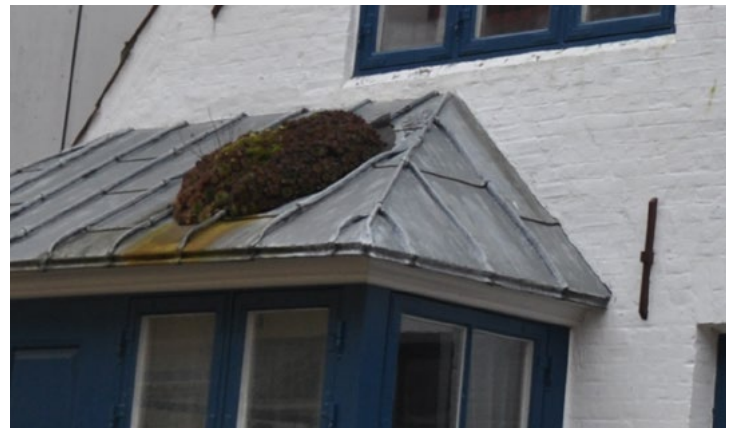
Fiskergade 3. Karnappen er tækket med bly. Mødet mellem murværk og tagdækning er forskælet fint ind i murværket.
