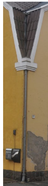
Lavgade 17. Mansardtaget samles i opsamlere og ledes via hjørnereces væk i nedløbsrøret.
