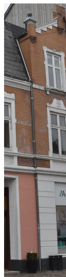
Nørreport 14. Nedløbsrør ligger bag de gennemgående cordongesimsen.
