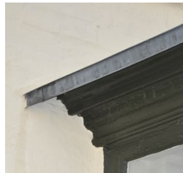
Slotsgade 11. Enkelt tagdryp udført i zink, sådan at de fine snedkerdetaljer på karnappens gesims fremstår pænt.
