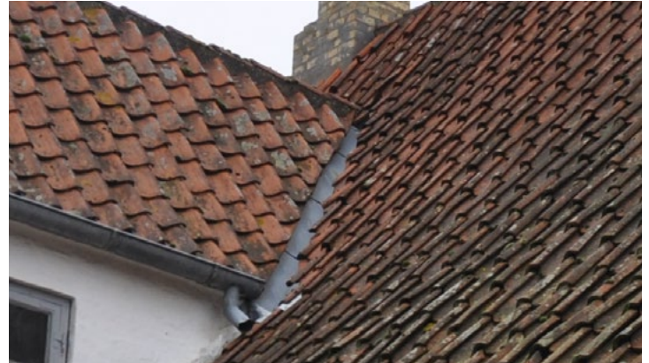
Gildegade 15. Skotrende med zink. Tagsten afskæres skråt forned. Renden må ikke blive for bred, men skal også kunne optage vandet fra de omkringliggende tagflader. Her fra hovedtaget og gavlkvist.
