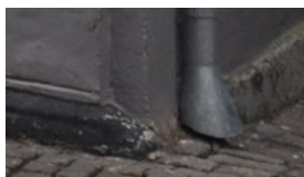
Ramsherred 45. Overgangen mellem nedløbsrør og brønd har form som en omvendt, let asymmetrisk tragt.
