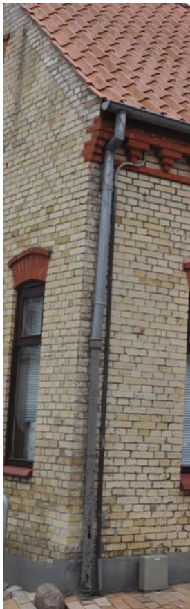
Gildegade gang 2. Bajonetknækket holder sig fri af gesimsen. Nedløbsrøret er ført til malet støbejernsrør.
