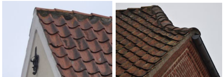
Slotsgade 15 og Slotsgade 31. Rygningen er lagt i mørtel og vingeteglene er lagt ud over de fritstående gavlmure. Afslutningerne er byggetraditionelt enkle, giver et godt helhedsindtryk og er simple at vedligeholde. Ved vedligehold skal man være opmærksom på løse sten, at løst mørtel fjernes, at underlaget sikres og renses for evt alger. herefter påføres ny mørtel.
