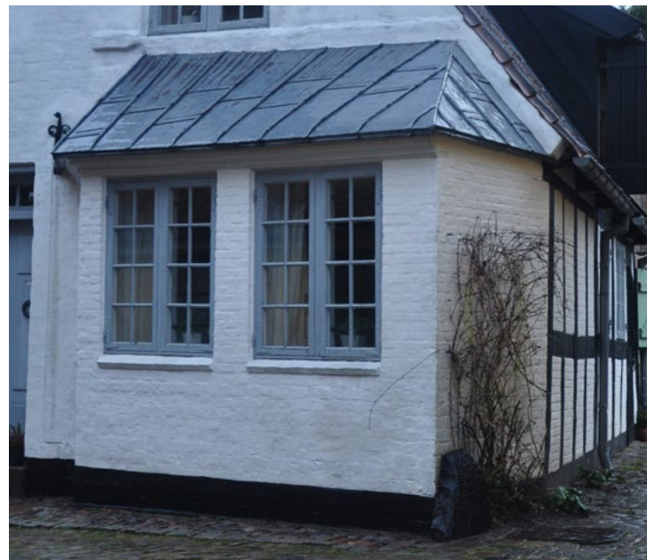
Jomfrugangen 1a. Karnappen er tækket med bly. Mødet mellem murværk og tagdækning er forskælet fint ind i murværket.
