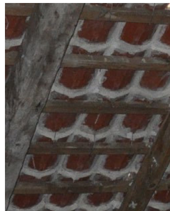
Understrøget tag med mørtel. Mørtlen holdes under opsyn, og eventuelle skader udbedres med ny mørtel. Tagsten kan genbruges ved omlægning
