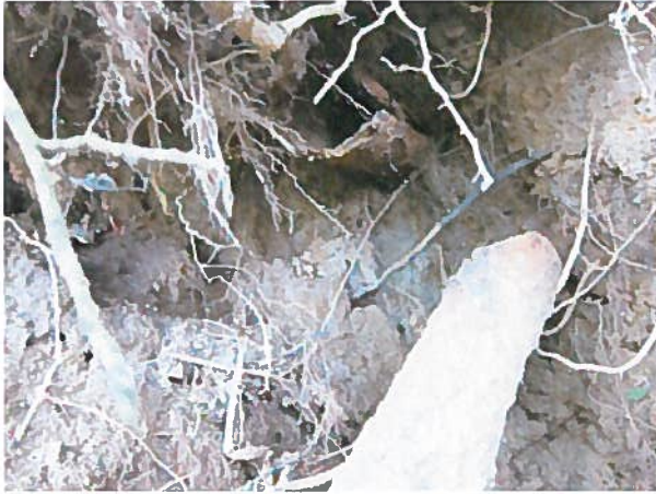
Rør, der stikker ud fra skrænten.
