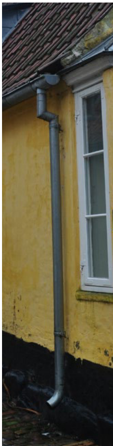
Nygade 33. Nedløb med bajonetknækket og udskudt udspyr.
