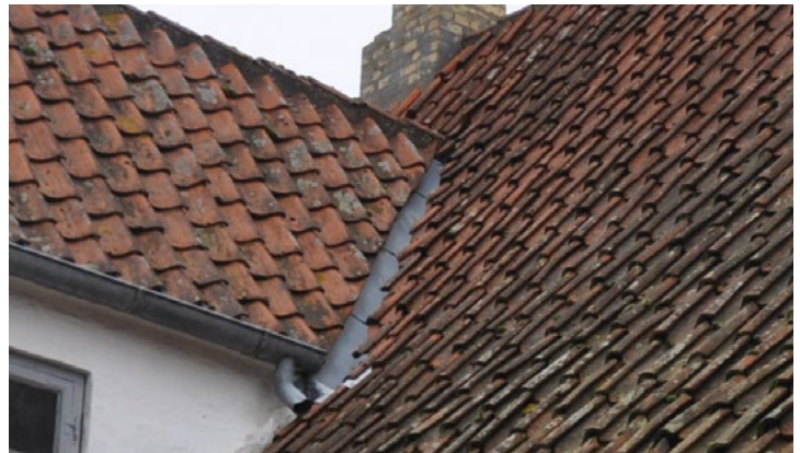
Gildegade 15. Skotrende med zink. Tagsten afskæres skråt forned. Renden må ikke blive for bred, men skal også kunne optage vandet fra de omkringliggende tagflader. Her fra hovedtaget og gavlkvist.
