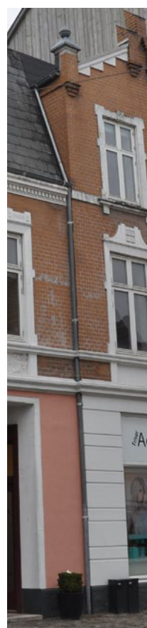
Nørreport 14. Nedløbsrør ligger bag de gennemgående cordongesimsen.
