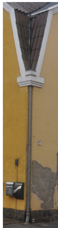
Lavgade 17. Mansardtaget samles i opsamlerskål og ledes via hjørnereces væk i nedløbsrøret.
