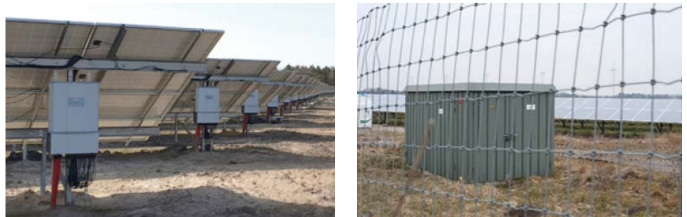
Figur 1-7: De hvide bokse på bagsiden af solpanelerne er invertere som skal omdanne jævnstrømmen til vekselstrøm. Til højre, ses et eksempel på en teknikbygning ("transformerkiosk").
