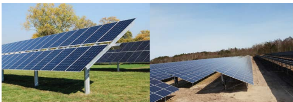
Figur 3-11: Projektmodel og referencefotos. Til venstre ses et anlæg der er monteret på et fast stativ. Til højre vises en model der er monteret på stativer med trackermekanisme.
