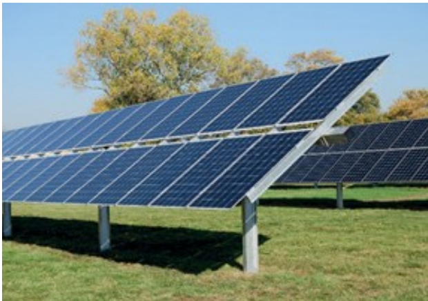
Solceller monteret på stativer med trackermekanisme
