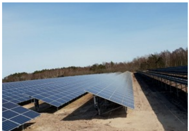
Solceller monteret på faste stativer
