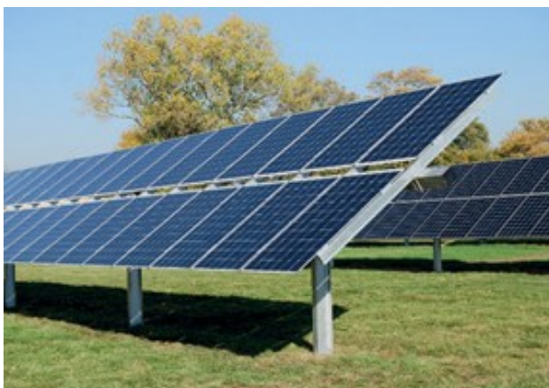
Solceller monteret på stativer med trackermekanisme
