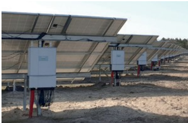
De hvide kasser under solcellerne er invertere, som omdanner jævnstrømmen til vekselstrøm
