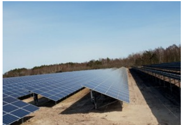
Solceller monteret på faste stativer
