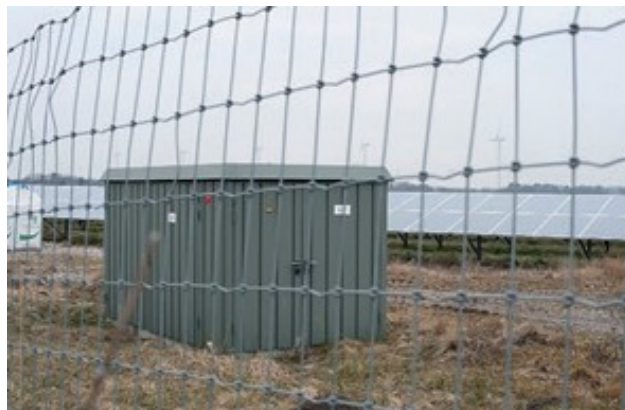
Eksempel på en teknikbygning, her en typisk transformerkiosk der transformere strømmen op til 10 kV
