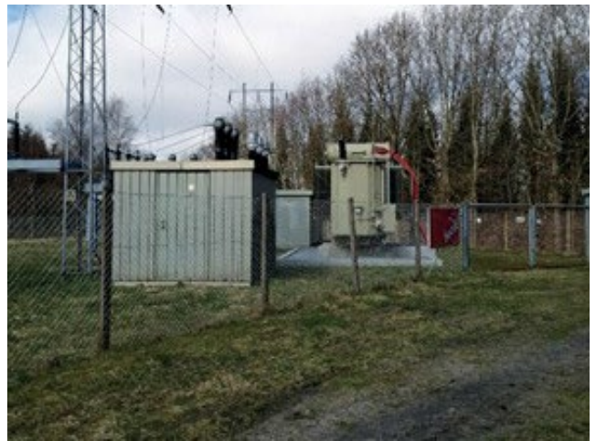
Eksempel på transformatorstation
