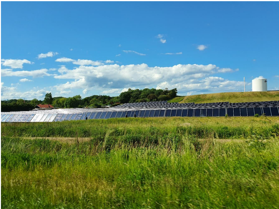
Et solvarmeanlæg ved den sjællandske motorvej.
